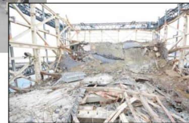
崩落屋根状況
