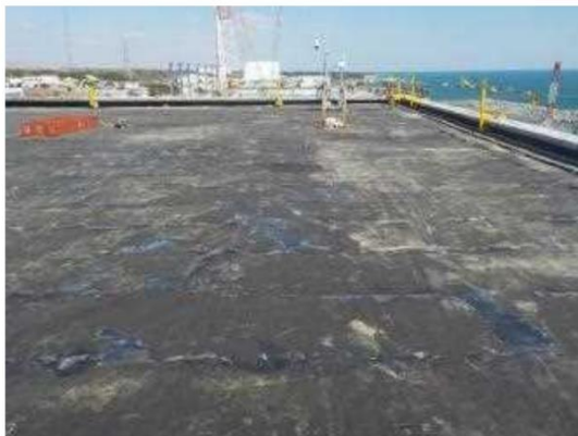
2R/B上屋対策状況
