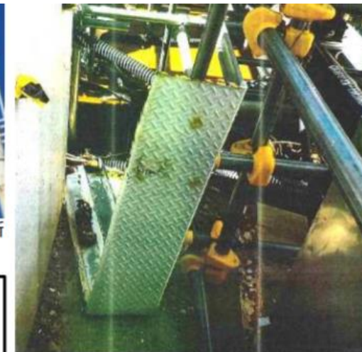
落下した点検用の足場
