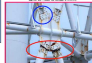
破断及び変形と判断した箇所の例
