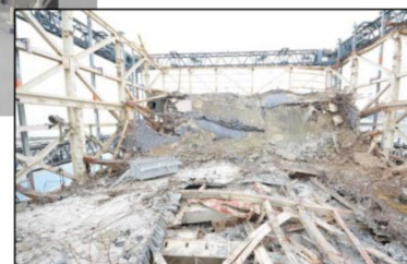
崩落屋根状況
