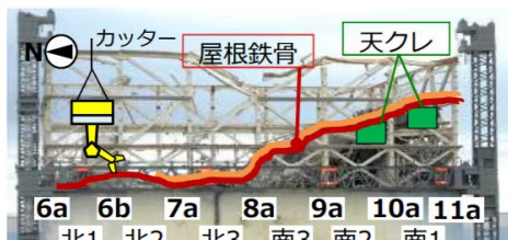
図1 崩落屋根形状(西面より)
