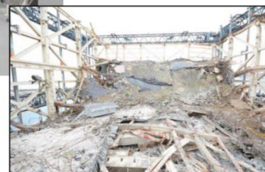
崩落屋根状況
