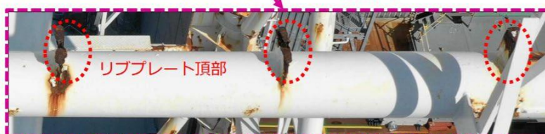
【写真②】 落下した足場があったと推定される箇所
