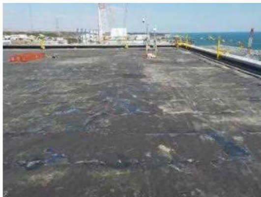
2R/B上屋対策状況
