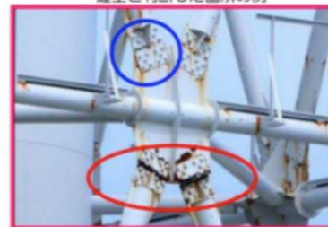
破断及び変形と判断した箇所の例
