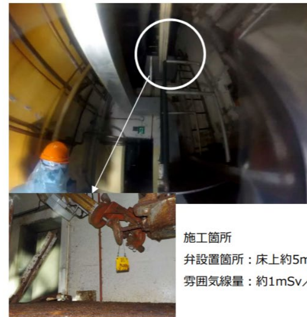
原子炉キャビティ差圧調整ライン状況 2
