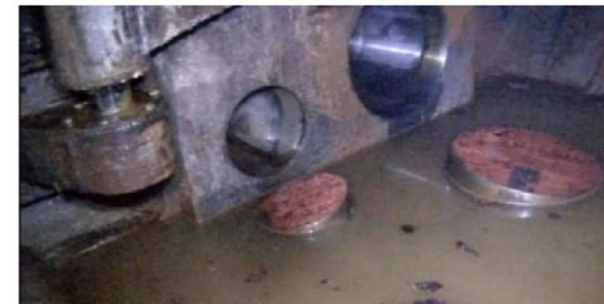
X-2ペネ外扉の状況 (C方向から撮影)
