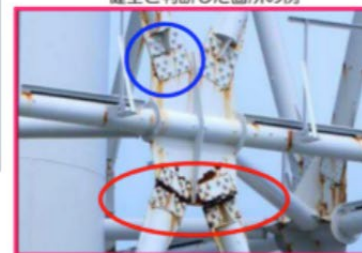
破断及び変形と判断した箇所の例
