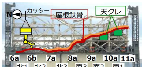
図1 崩落屋根形状(西面より)
