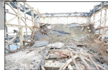
崩落屋根状況
