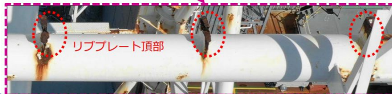
【写真②】 落下した足場があったと推定される箇所
