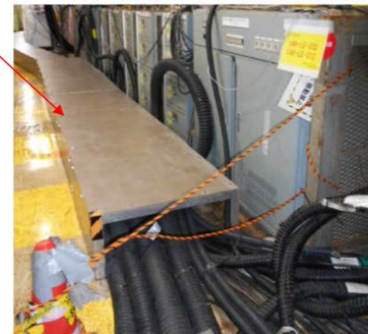
金属トラフ出口側
