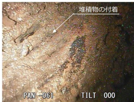
撮影場所A グレーチング脱落部②
