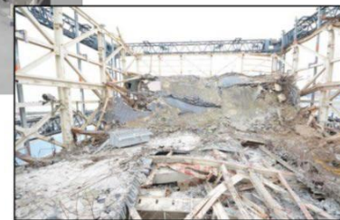
崩落屋根状況
