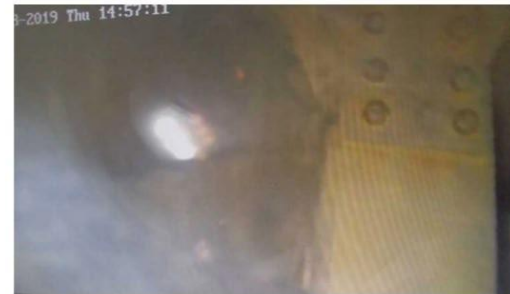
筒身内部支障物（H鋼）写真
